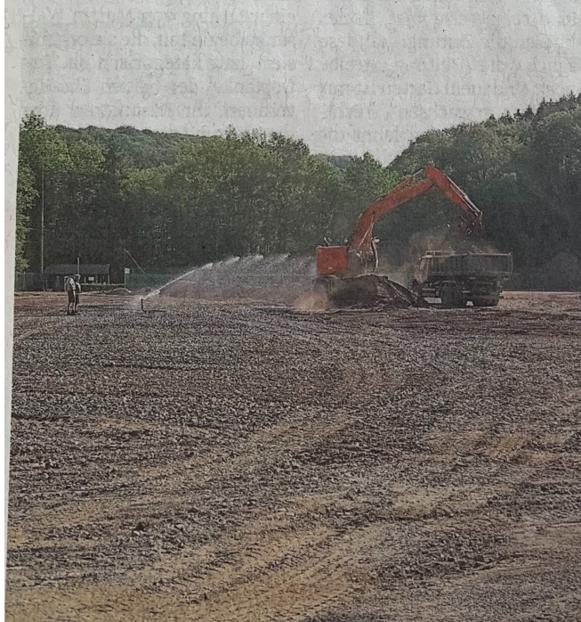
An der Staelsmühle wird derzeit schon viel gearbeitet. Im Oktober soll der Platz fertig sein. Foto: SSV
