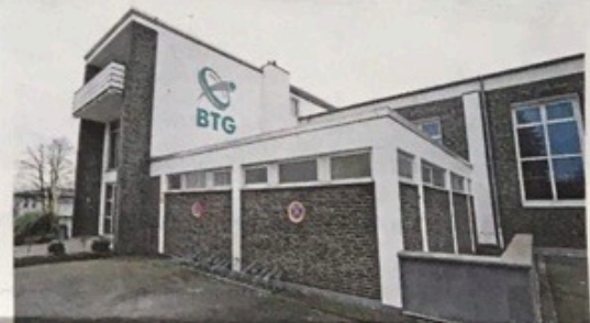
Wegen des Corona-Lockdown ruht der Sportbetrieb auch bei der BTG aktuell, eine gute Zeit für Sanierungsarbeiten.
