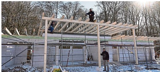
Das Richtfest für ihr neues Tennisheim feierten die Mitglieder der TG Grün-Weiß aus Voiswinkel. Gefördert wird das Projekt mit 160 000 Euro aus den „Modernen Sportstätten 2022“. Foto: Anton Luhr
